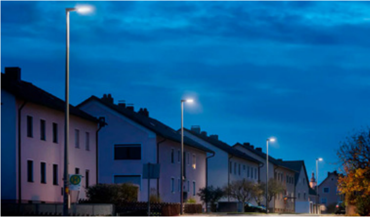
Auf- / Ansatzleuchten Kantonsstrasse
